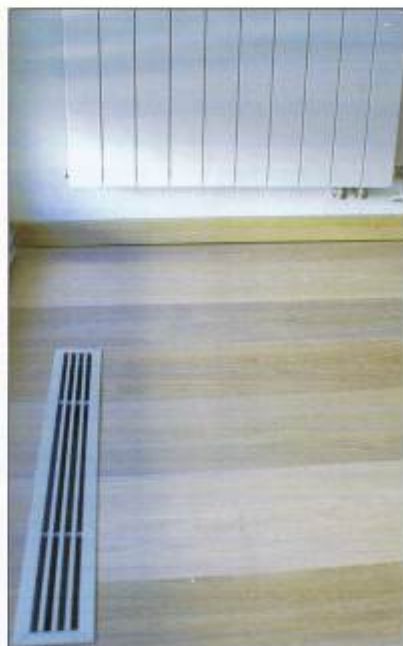
Radiateur avec servomoteur proportionnel régulant l'ouverture de la vanne avec une précision de 1/100e de mm. A gauche, la prise d'air de la ventilation double flux.
