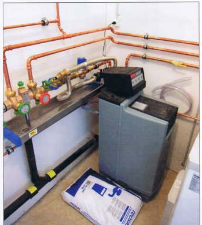
Dans la buanderie, un adoucisseur d'eau permet de ménager la tuyauterie sur le long terme.
