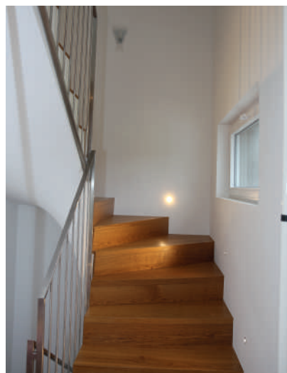
Au milieu de la nuit, seul l'éclairage d'orientation est activé en cas d'appui sur un interrupteur.
