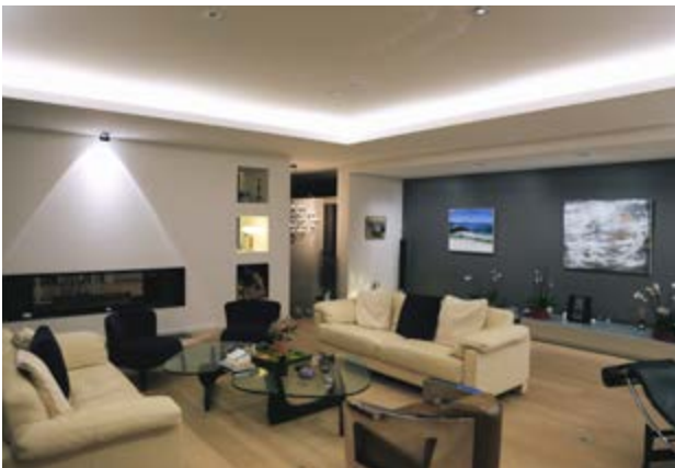
Die Beleuchtung lässt sich dank KNX «auf den Millimeter genau» einstellen.
